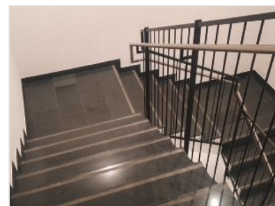
CORRIMANO E PARAPETTI IN ACCIAIO NEL VANO SCALA
