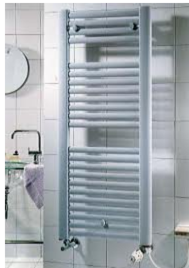
BADHEIZKÖRPER IM HAUPTBAD
